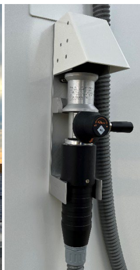
Abbildung 3-8 Wasserstofftankstelle mit zwei Dispensern, zugehörige Tank- kupplung nach SAE J2600
