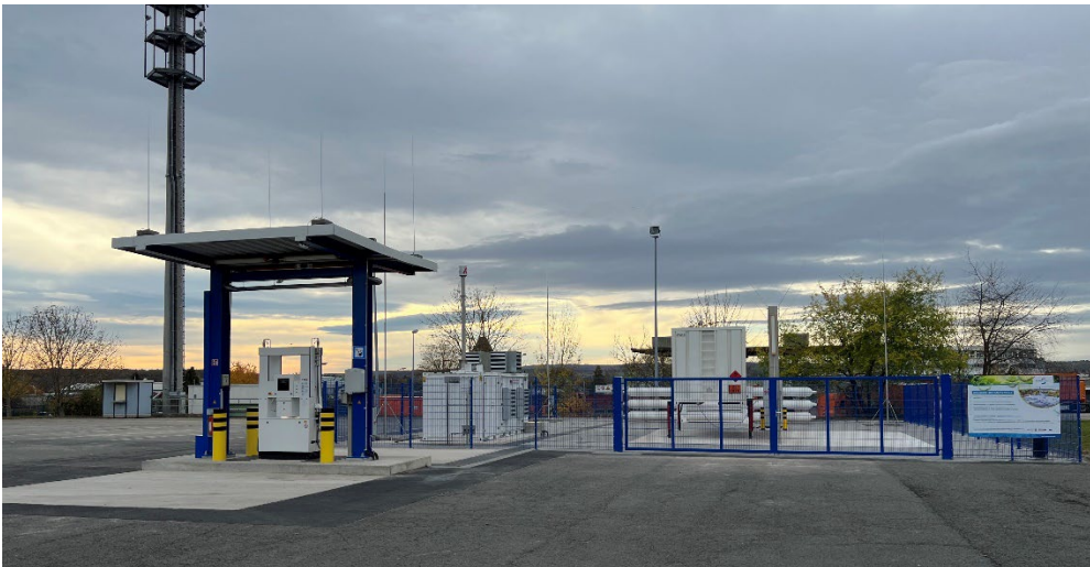
Abbildung 3-10 Wasserstofftankstelle in einem Busbetriebshof
